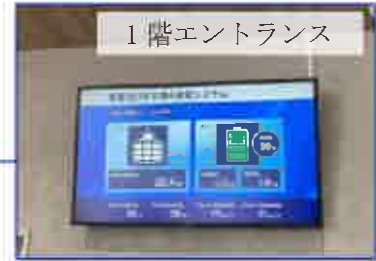
発電状況をリアルタイムに確認可能なモニターを設置
