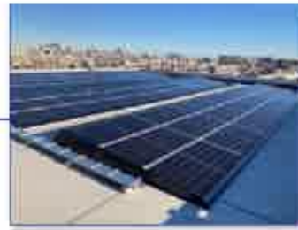
太陽光パネル
